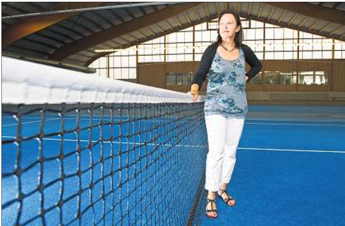
Will den Mitgliedern den Ernst der Lage klarmachen: Irène Kobelt, Kopräsidentin des Tennis Clubs Chur, in der sanierungsbedürftigen Tennishalle.
